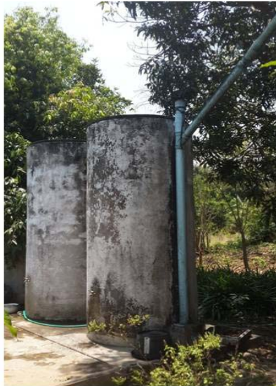
สภาพถังเก็บน้ำฝนของโครงการ
