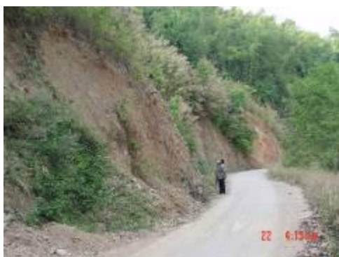
ดินถล่มเนื่องจากตัดถนนบนลาดเขา
