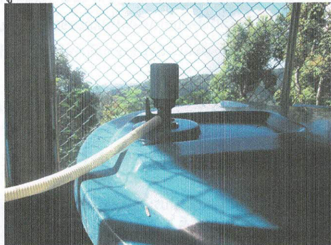
ลูกลอยควบคุมการทำงานของปั้มน้ำและหลอด UV
