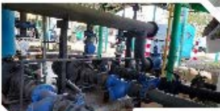
ระบบสูบน้ำ
