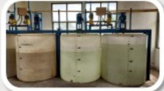
ระบบจ่ายสารเคมี
