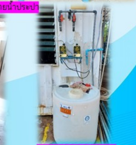
ระบบจ่ายสาร Pre-Chlorine
