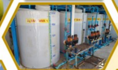
ระบบการจ่ายสารเคมี
