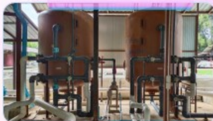
ระบบกรองคาร์บอน
