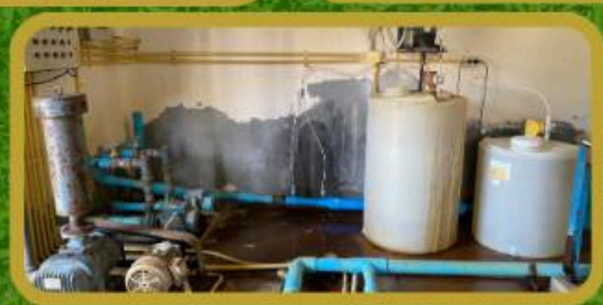
ระบบเติมอากาศและจ่ายสารเคมี
