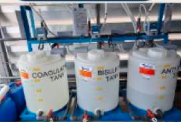
ระบบจ่ายสารเคมี
