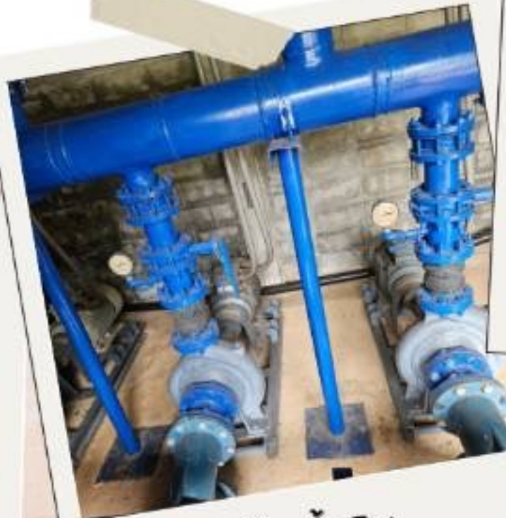
ปั๊มน้ำดิบ
