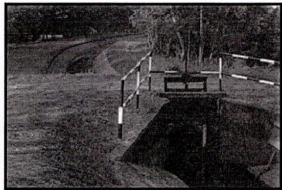
ท่อเชื่อม (Siphon)
